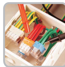
Test di connessione Connection test
